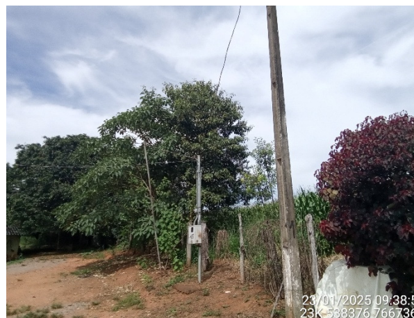
Figura 9.69 - Padrão de energia elétrica em Coqueiros
