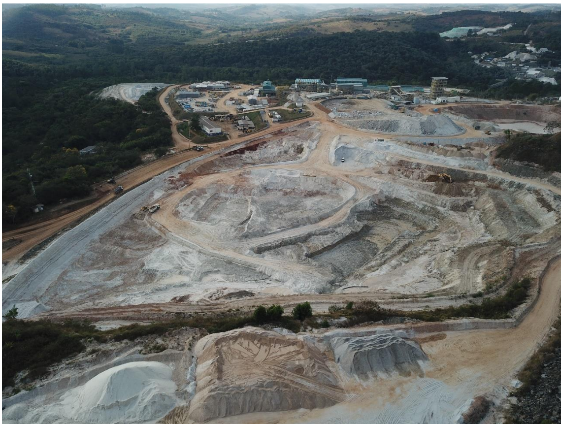
Figura 7.32. Fotografia panorâmica da Barragem VG2 mostrando o andamento da remoção das etapas 5, 6, 7 e 8 do processo de descaracterização da barragem (AMG, ago/2023). Vista da ombreira esquerda sentido ombreira direita.
